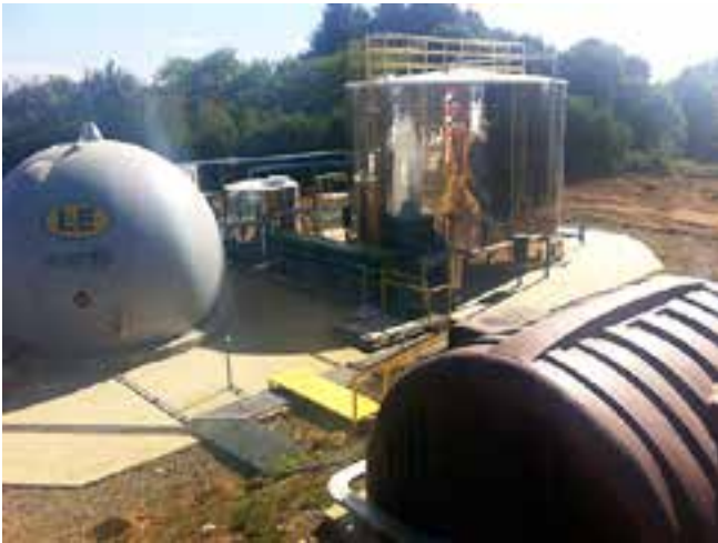
La Planta de Schwager Biogás, desarrollada y construida en conjunto con Lácteos Osorno, en Osorno.
