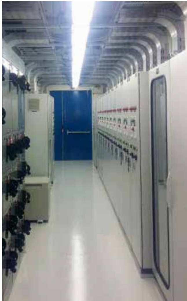
Una vista amplia de la Sala Demostrativa, en el marco del proyecto desarrollado por Schwager Service para Minera Lomas Bayas, de la Compañía Minera Glencore.
