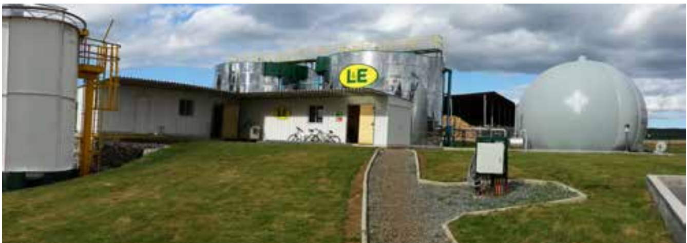
Planta de Biogás en Osorno
