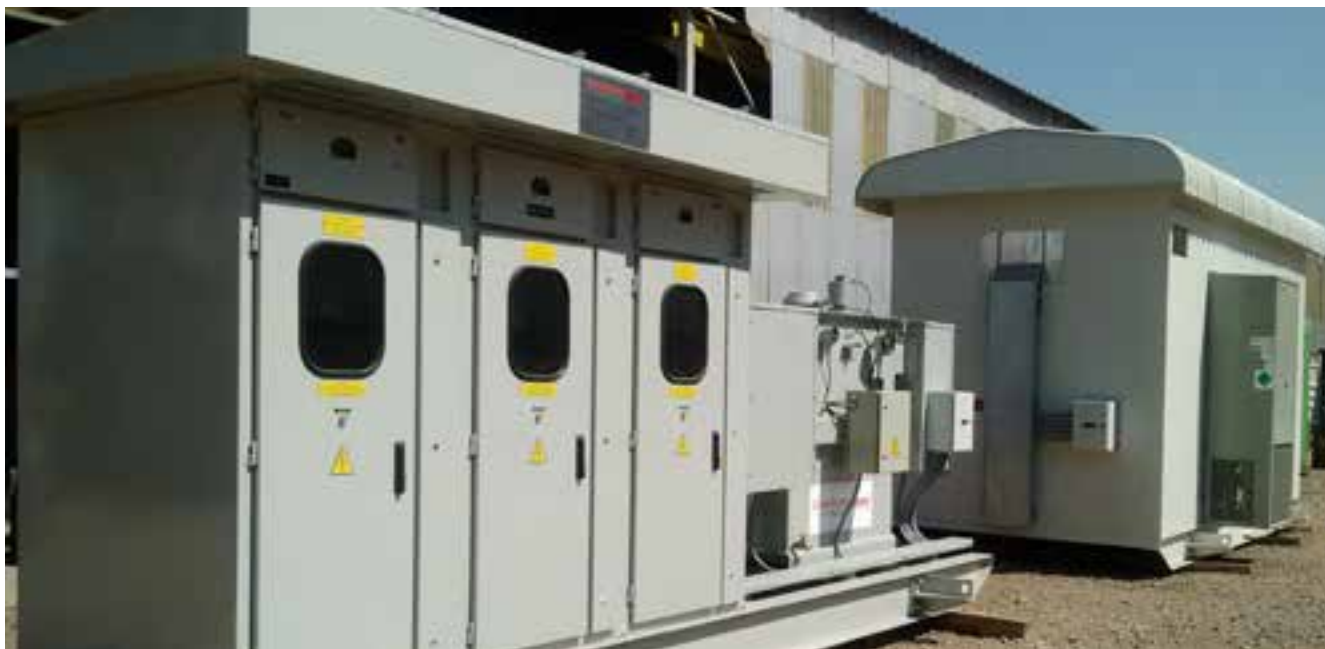
Sala Eléctrica y Subestación en Minera Barrick.
