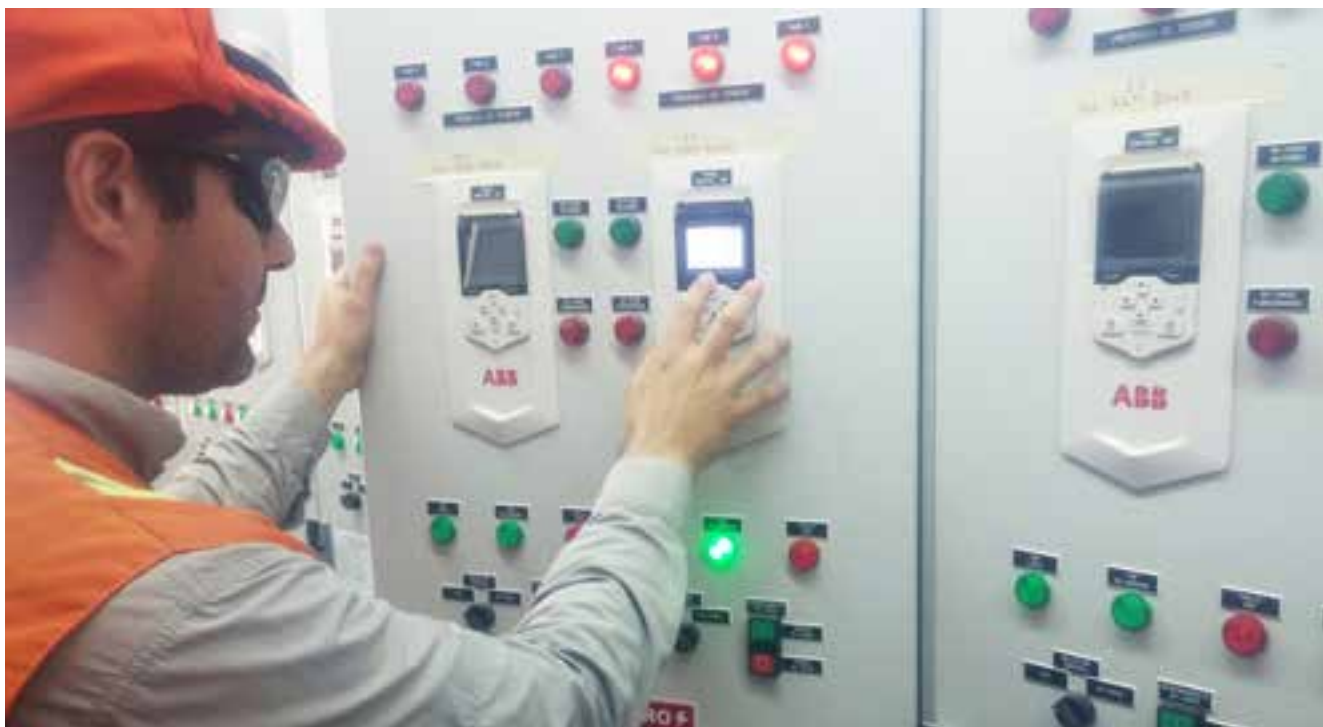
Sala Eléctrica en funcionamiento en Minera Lomas Bayas, en el marco del Proyecto "Planta Demostrativa".
